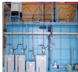
小型UF膜含油廃水処理ユニット
