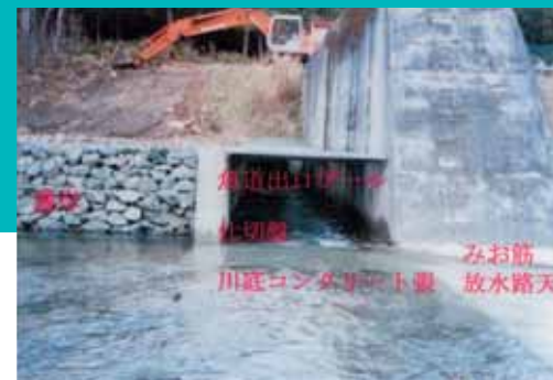
IM式魚道導入後 平成15年11月、魚道機能の正常化を目的に、IM式魚道を導入した。IM式魚道の内容は、仕切盤、魚道出口プール、みお筋、川底コンクリート張、護岸、副堤嵩上げ、等である。
