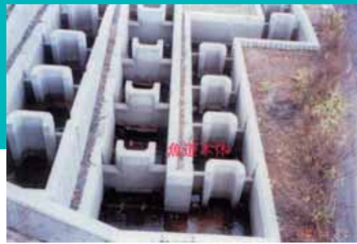
IM式魚道導入前 IM式魚道導入前は魚道本体での流水が認められなかった。
