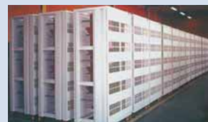
デジタル式電子交換機筐体
